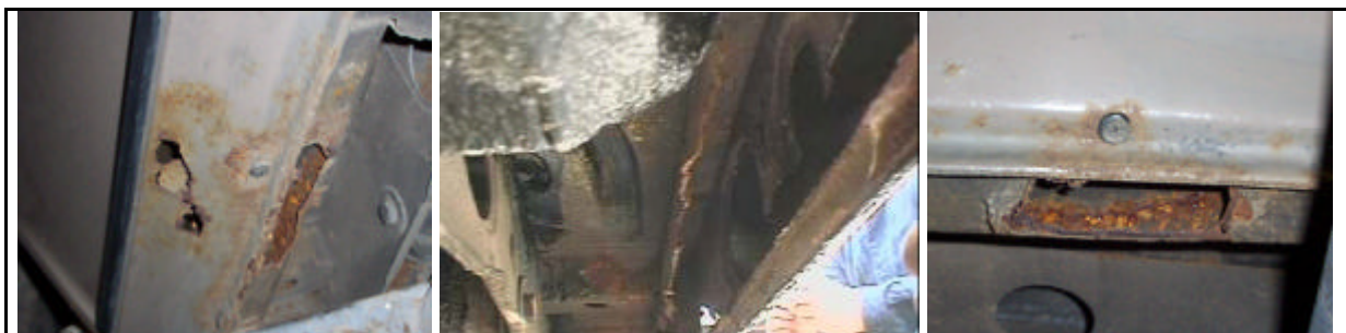
Schweller: solche Durchrostungen sind recht häufig zu finden ! Prüfen Sie genau !!
